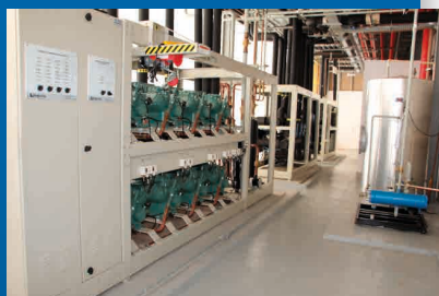
Casa de Máquinas CD Covabra
