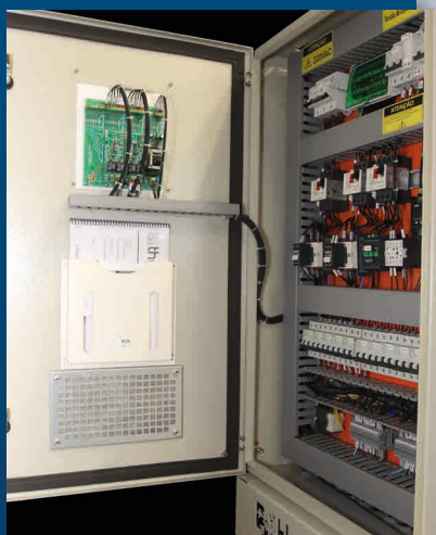
Quadro Elétrico Rack de CO 2
