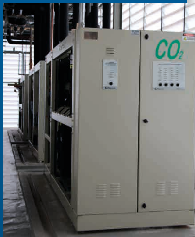
Rack de CO 2
