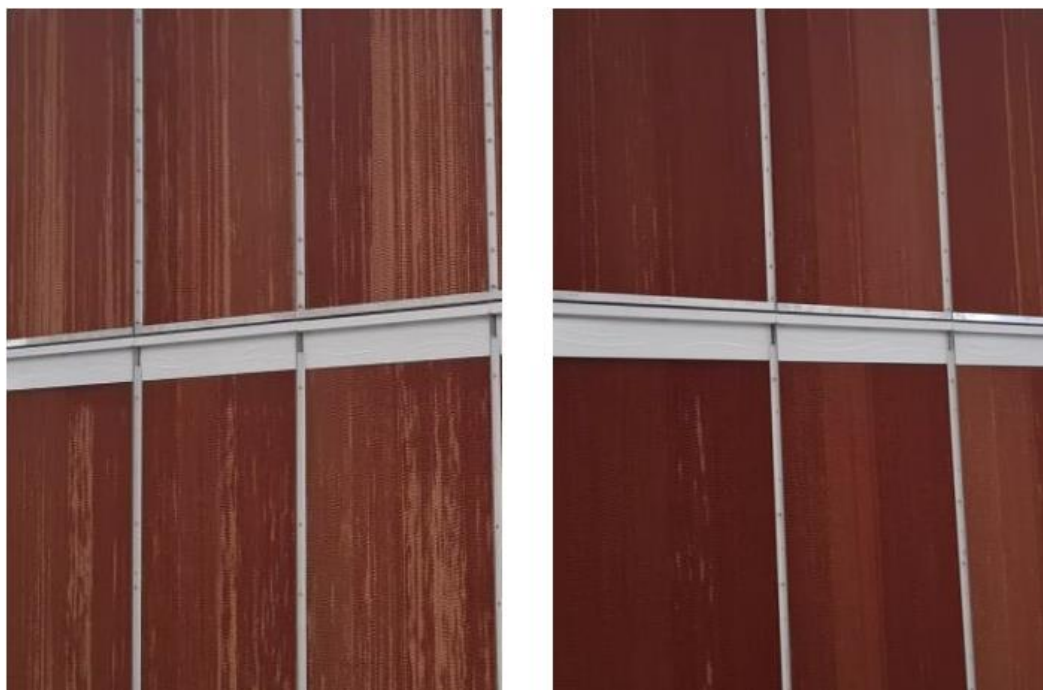
Figura 9 - Painel durante o processo (esquerda) e painel completamente úmido (direita).
