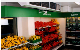
Climatização de ambiente
