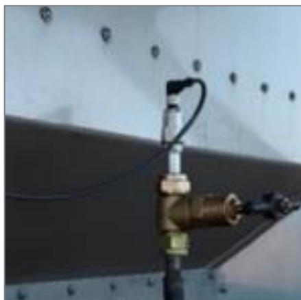
Figura 5 – Sensor de pressão instalado.
