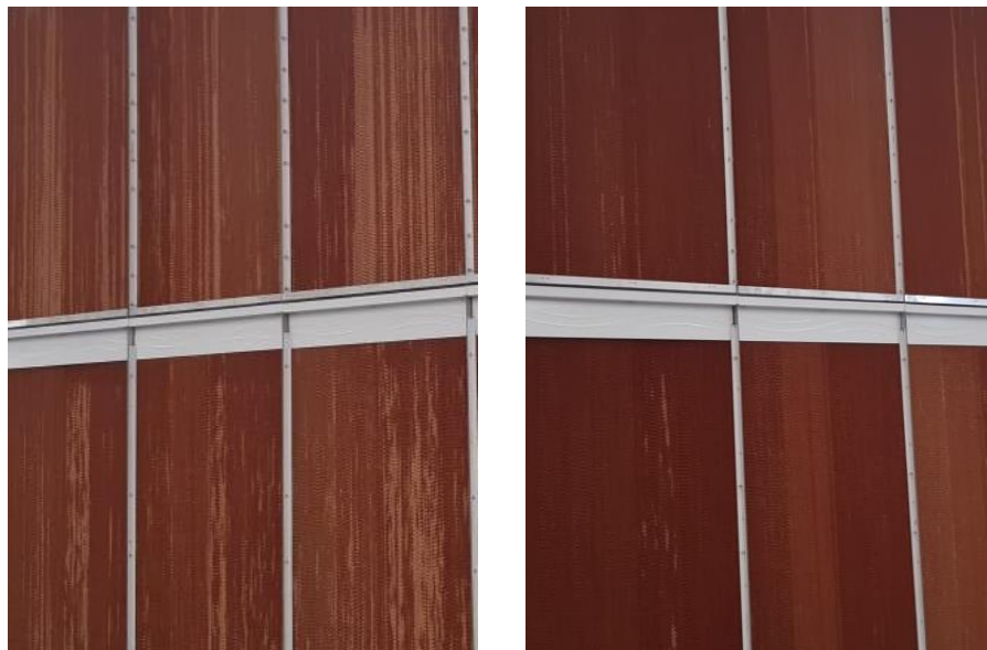
Figura 1. La distribución de agua proviene de los paneles de enfriamiento del distribuidor en la parte superior. Los paneles de enfriamiento pasan de seco a húmedo.
